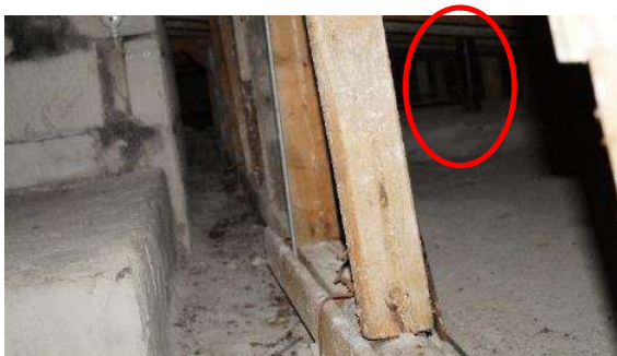
Kuva LVI-32. Vesikaton ja yläpohjan välisessä kylmässä tilassa jätevesiviemärit ovat alkuperäisiä valurautaviemäreitä ilman eristyksiä. Viemärit on sisäpuolisesti pinnoitettu 2009.
