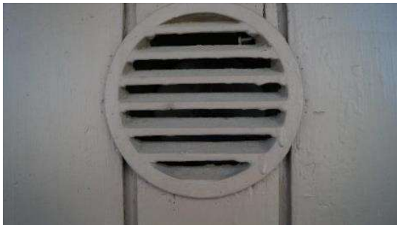
Kuva LVI-57. Sisäpihan kellaritiloissa raitisilma otetaan ulkosäleikön kautta, ulkoseinän läpi.
