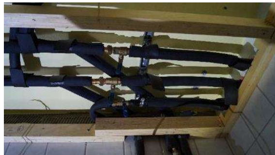
Kuva LVI-21. Kuva asennon kylpyhuoneen alakattotilan asennuksista. Vesijohdot kupariputkin, puristusosia, solukumieristein.
