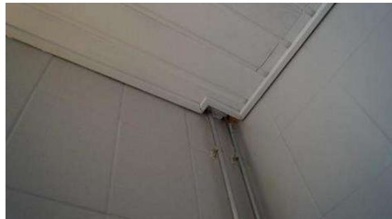
Kuva LVI-23. Alakatosta vesikalusteille vesijohdot ovat pääosin näkyvissä, kromatuin kupariputkin ja osin.
