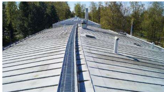
Kuva LVI-33. Tuuletusviemäriin on asennettu vesikatolla jäätymissuojat.
