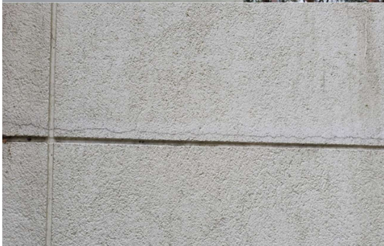
Levyjulkisivut ovat hieman likaantuneet
