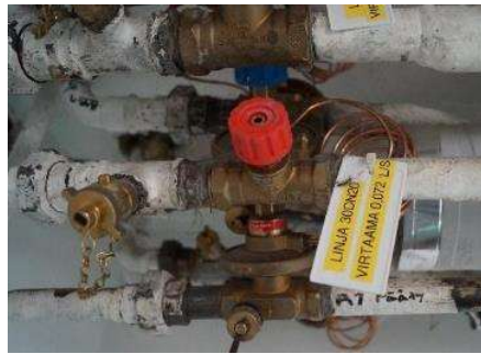
Kuva LVI-13. Lämmitysverkoston linjasulku- ja linjasäätöventtiilit ovat uusittuja automaattiventtiilejä Danfoss AS-P ja ASV-M.
