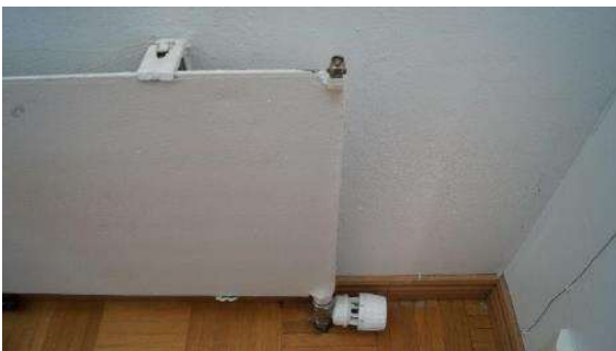
Kuva LVI-10. Asunnoissa patterilinjojen nousut sekä putkihajoitukset ovat lattia- ja seinärakenteiden sisään asennettuja.
