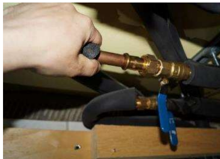
Kuva LVI-27. Kuva kylpyhuoneen alakattotilassa olevista huoneistokohtaisista suluista.
