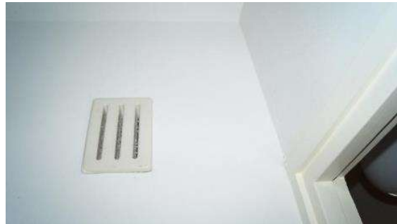
Kuva LVI-62. Alkuperäinen poistovenktiili, jonka toiminnallisuus koneellisessa poistoilmanvaihdossa heikko (asunnoissa, kellarissa ja porrashuoneiden poistoissa käytössä).
