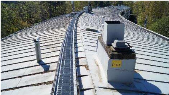
Kuva LVI-48. Kuvassa takkaimuri. Toinen takkaimuri on pellitetty "tötterön" sisään.
