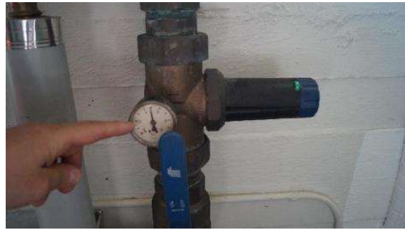
Kuva LVI-19. Vesimittarin jälkeen virtaussuunnassa on paineenalennusventtiili / vakiopaineventtiili.
