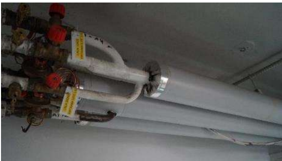
Kuva LVI-8. Lämmitysverkoston runkojohdot kulkevat kellarikäytävällä ja kellaritiloissa näkyvissä. Liitokset hitsaten ja kierreosin.
