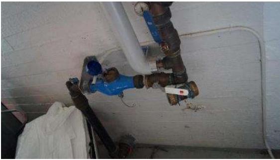
Kuva LVI-18. Kuva kiinteistön päävesimittarista, joka sijaitsee lämmönjakuhuoneessa.
