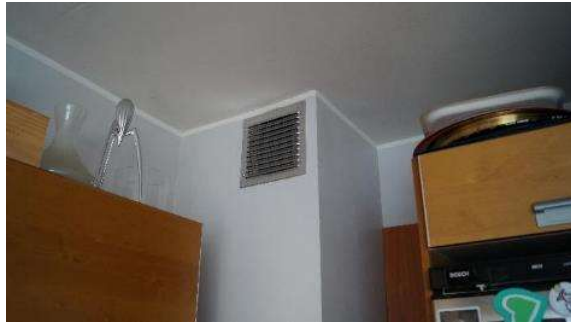
Kuva LVI-60. Kuvassa keittiössä oleva poistosäleikkö, joka ei ole säädettävissä (koneellinen poistoilmanvaihto)
