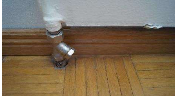
Kuva LVI-17. Kuva uusitusta patterin paluuventtiilistä.
