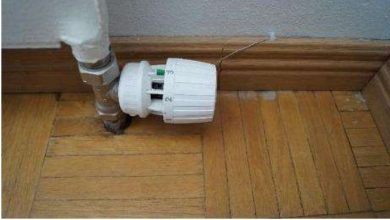
Kuva LVI-16. Kuva uusitusta patteriventtiilistä ja termostaattiosasta.
