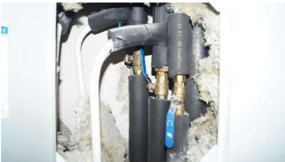
Kuva LVI-20. Kuva asunnon nousulinjan tarkastusluukusta. Vesijohdot ovat kupariputkin asennettuja. Rakenteisiin menevät putkiasennukset on tehty muovitetulla kupariputkella.
