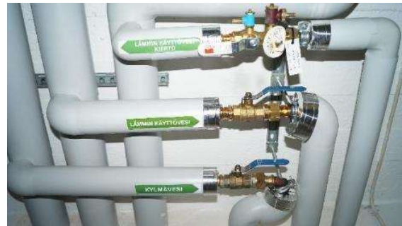
Kuva LVI-25. Kuva nousulinjan käyttövesisuluista kellarin katossa.
