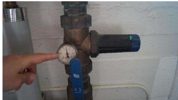
Kuva LVI-2. Käyttöveden paine vaihtelee nopeasti välillä 3,5 - 5,0 bar.
