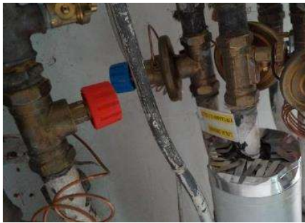
Kuva LVI-12. Lämmitysverkoston linjasulku- ja linjasäätöventtiilit ovat uusittuja automaattiventtiilejä Danfoss AS-P ja ASV-M.
