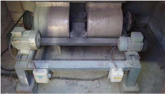
Kuva LVI-3. IV-puhallinkammion kiilahihna vinkuu.
