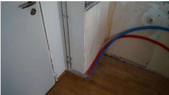
Kuva LVI-22. Keittiöille putkia on tuotu osittain pinta-asennuksena kromatuin kupariputkin ja osin sekä PEX-muoviputkin suojaputkessa.
