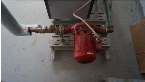
Kuva LVI-6. Kuva lämpimän käyttövesiverkoston kiertovesipumpusta.
