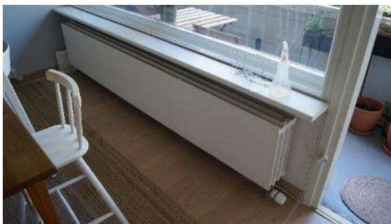
Kuva LVI-14. Asuinhuoneiden patterit ovat teräslevypattereita kulmakannakkein. Patteriventtiilit ja termostaatit on uusittu perussäädön yhteydessä 2012.
