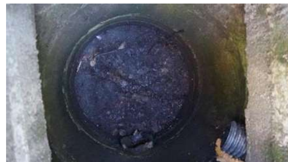
Kuva LVI-35. Autotallien edustalla olevan sadevesikaivon pohjalla kiintoainesta pohjalla.
