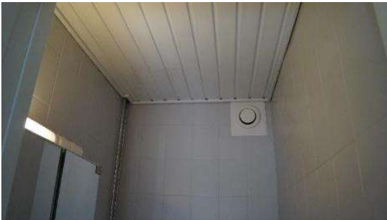
Kuva LVI-61. Erillis wc-tilassa oleva poistoilmaventtiili, joka on tarkoitettu koneelliseen poistoilmanvaihtoon.
