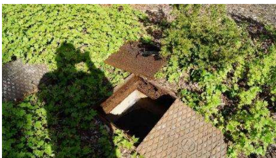
Kuva LVI-36. Sadevesien tarkastuskaivon kansi.
