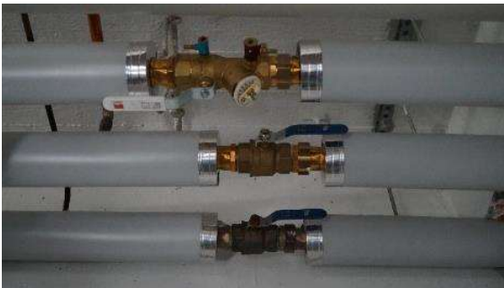
Kuva LVI-24. Kuva lämmönjakohuoneen runkolinjojen käyttövesisuluista ja linjasäätöventtiilistä (jossa sulku).
