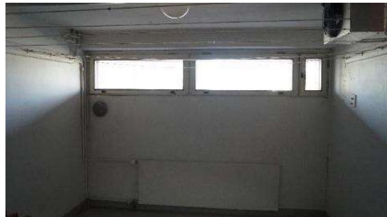
Kuva LVI-58. Sisäpuolella kellaritiloissa, joissa on raitisilmareitti, on käytetty metallista lautasventtiiliä.
