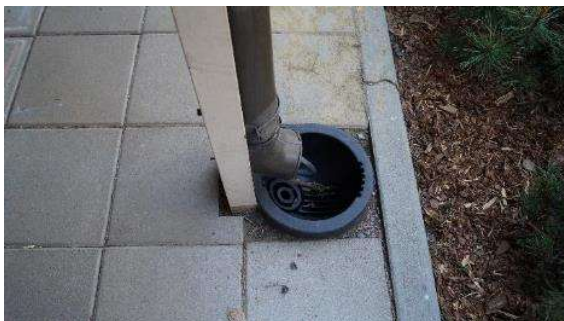
Kuva LVI-34. Vesikaton sadevedet johdetaan syöksytorvia pitkin rännikaivoille.
