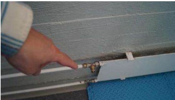
Kuva LVI-1. Kuntosalin lämmityspatterista puuttuu termostaatti tai käsisäätöpyörä.
